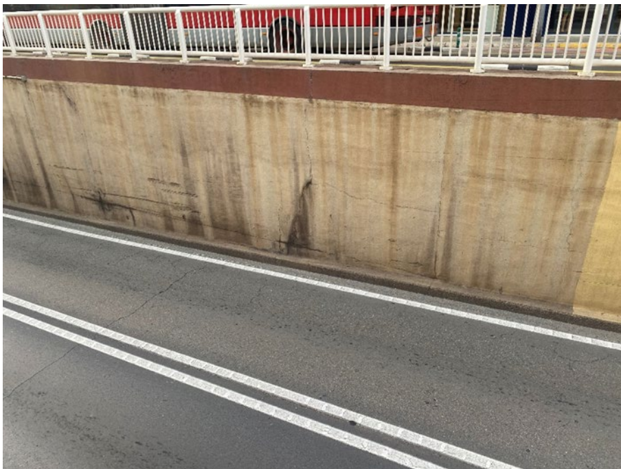
Il·lustració 18. Paramento fisurat en una de les rampes.
