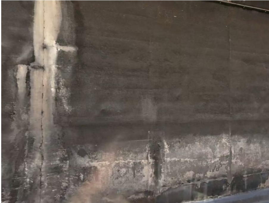
Il·lustració 17. Entrada de aigües per les juntes i en la base del mur.
