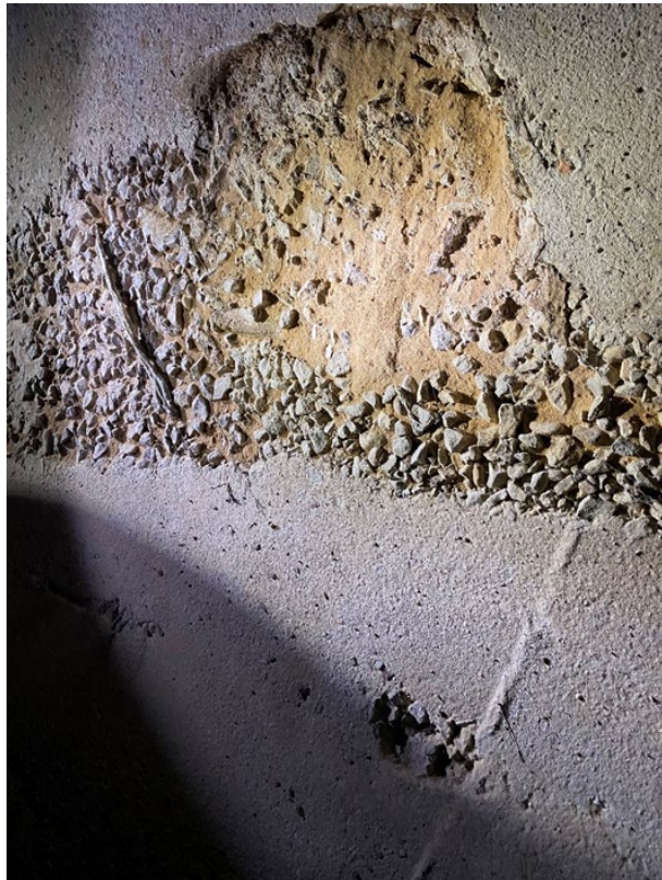
Il·lustración 12. Disgregación de la masa de hormigón en masa del colector.
