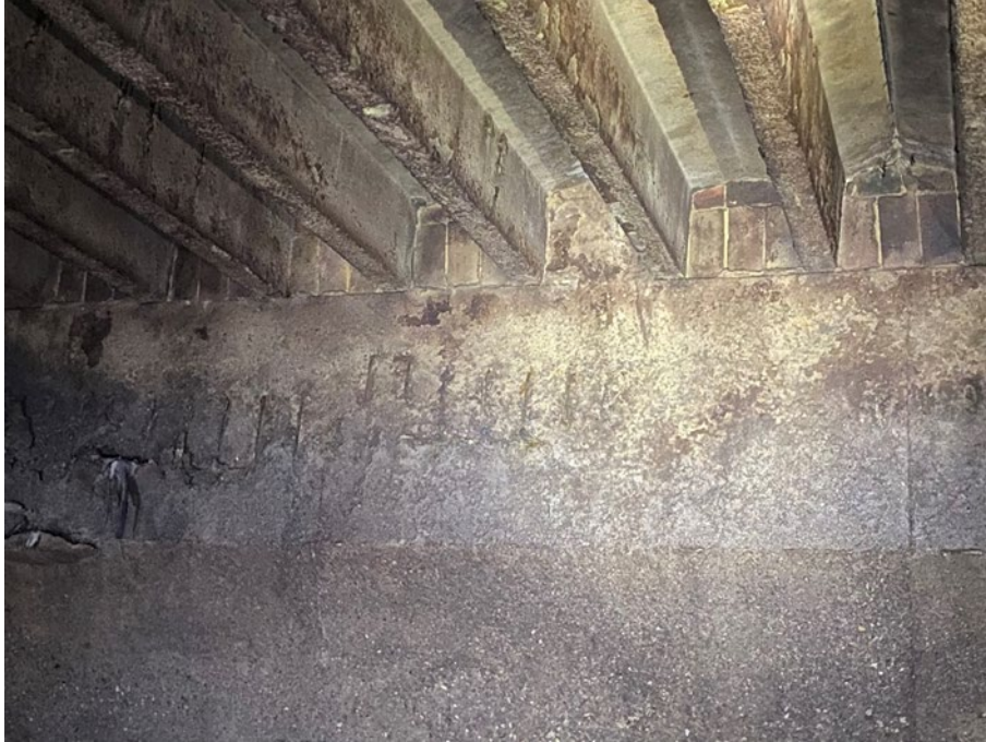
Ilustración 13. Armadura del prisma visible por falta de recubrimiento.
