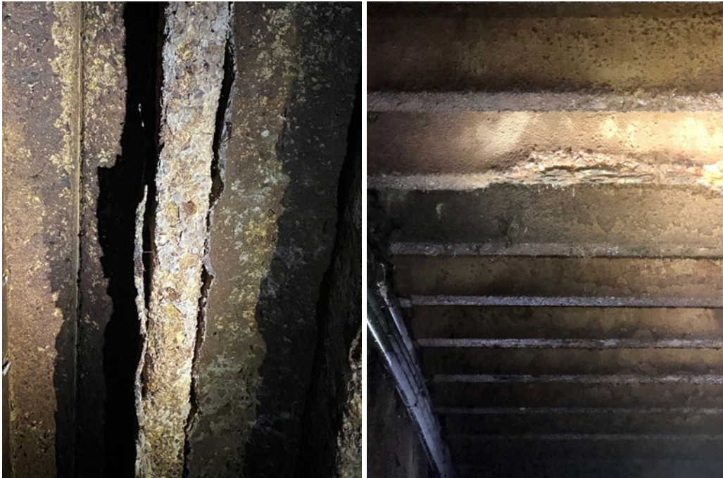
Ilustración 14. Detalles de las vigas más dañadas.
